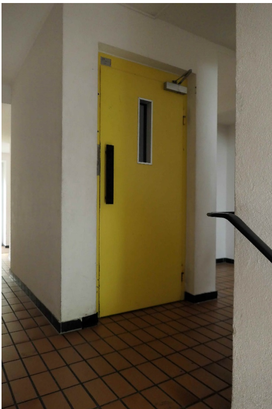
Lift im Erdgeschoss (2020)
