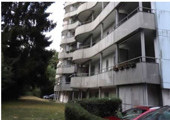
Abbildung 16: Bahnhofstrasse 56-58, 2022, Südostfassade mit grossen, geschwungenen Balkonvorbauten aus Stahl. Eternitfassade zeigt Vermoosung (Quelle: Denkmalwerkstatt 2022).
